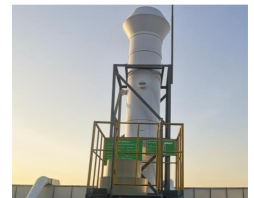
废气处理设施
