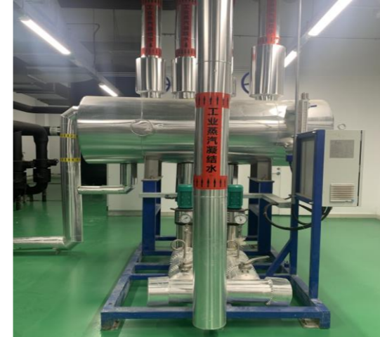
蒸汽凝结水回收装置
